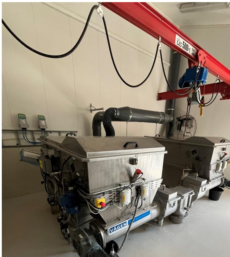
Figur 17: Soby-filter i Sentrum renseanlegg (Foto Rambøll, 26.06.2024)
